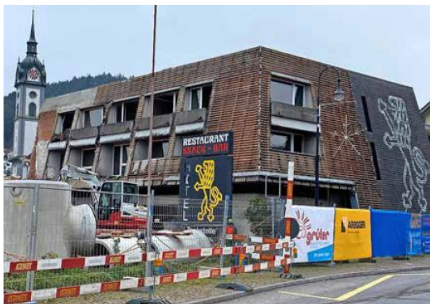
Der Rückbau des Gasthofs Löwen ist in vollem Gang. Foto Anna Graf
