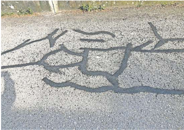
Flicke und Rissanierungen auf Gemeindestrassen gelten als betrieblicher Unterhalt und werden auch weiter ausschliesslich durch die Gemeinde bezahlt. Anders sieht es aus, wenn auf einem Stück ein neuer Deckbelag fällig wird. Bild: Adelheid Aregger
