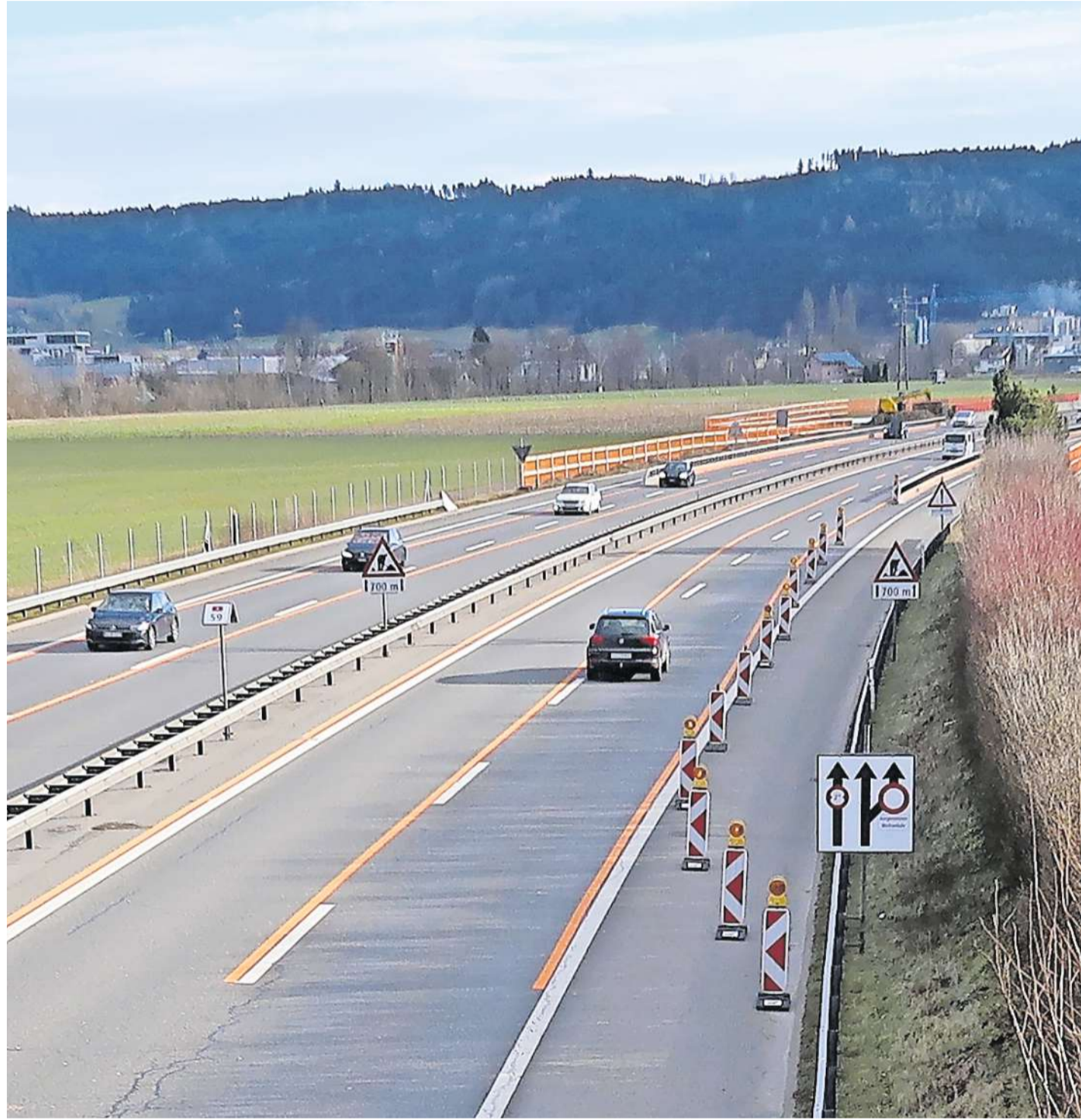
Die Autobahn A2 in Fahrtrichtung Süden. Im Hintergrund die Baustelle des Bundamts für Strassen für die Wildtierbrücke bei Langnau.
